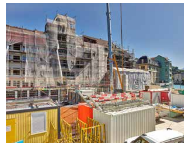
Umfangreicher Umbau: das «eingerüstete» Falken-Gebäude und die über der Aare stehende Baubrücke.
